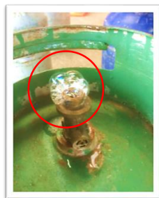
Figura N°4: Fuga en válvula de acoplamiento rápido en cilindro de 11,36 kg (25 lb) mediante prueba de verificación con agua jabonosa
