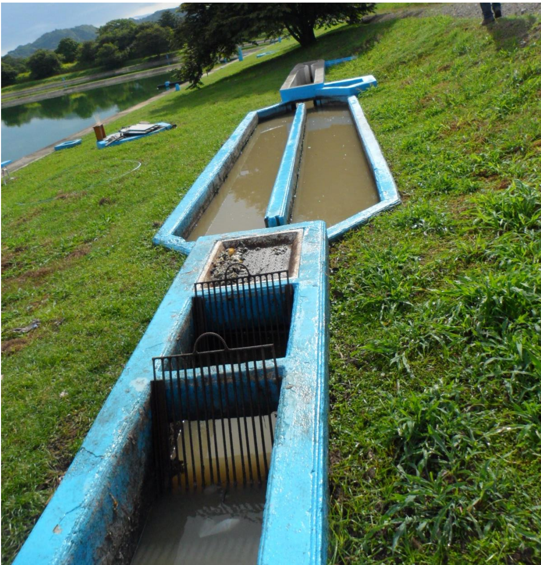
Fotografía 10. Rejillas para retención de sólidos gruesos a la entrada del sistema.
