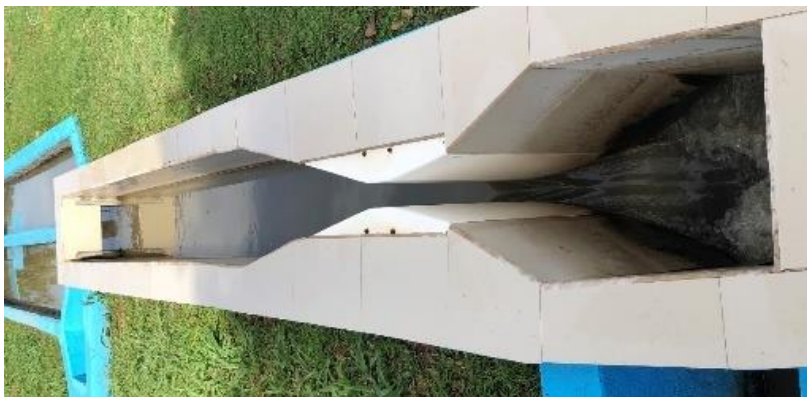
Fotografía 9. Vertedero Parshall para medición de caudal del afluente a las lagunas.
