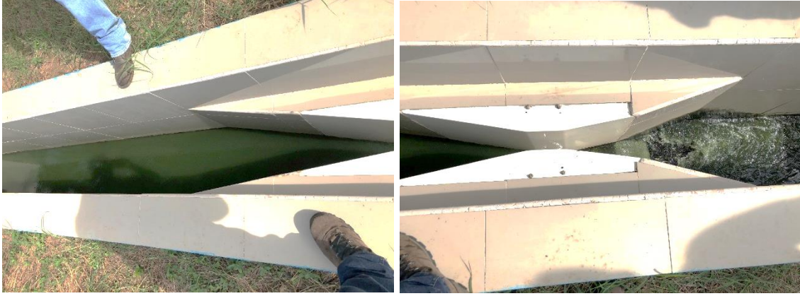
Fotografías 13 y 14. Coloración verdosa observada en el efluente total final de la última laguna.
