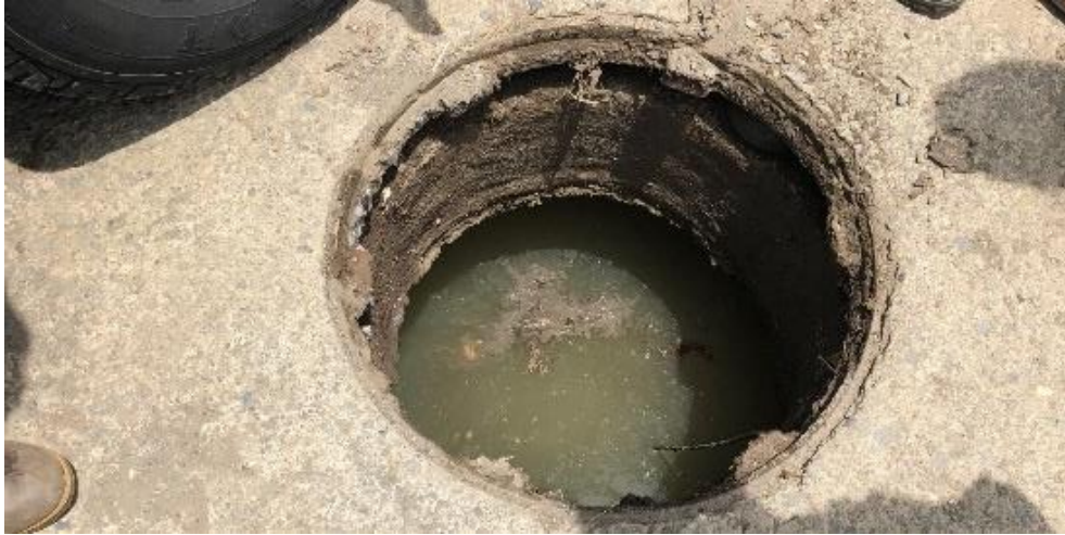
Fotografía 11. Red de alcantarillado inundada en el sector de la comunidad Boulevard del Sol.
