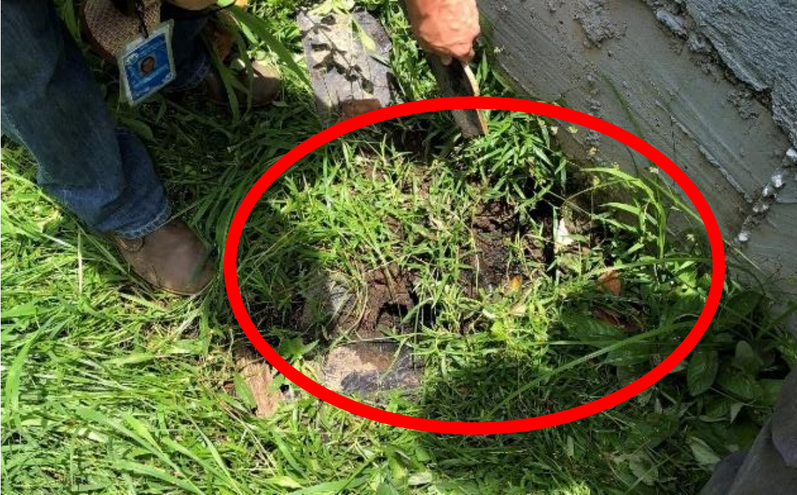
Fotografía 13. Posible afloramiento de aguas residuales en la parte posterior de la estación de bombeo en el sector de la comunidad Boulevard del Sol.
