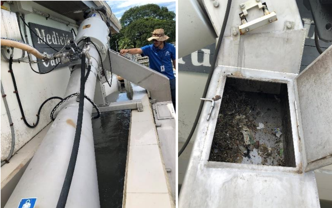
Fotografía 6. Tornillo sin fin como pretratamiento para retención de sólidos gruesos en el afluente de la PTAR.
