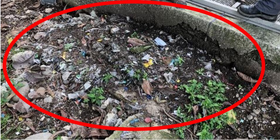
Fotografía 17. Residuos sólidos acumulados en la estación de bombeo de la comunidad de El Porvenir.
