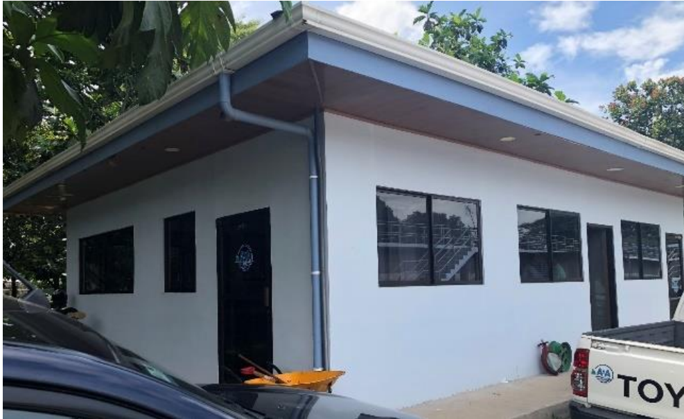
Fotografía 15. Zona en la cual se detectó la principal afectación por generación de olores alrededor del sistema de la PTAR.
