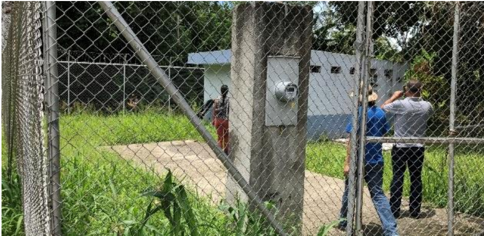
Fotografía 12. Estación de bombeo en el sector de la comunidad Boulevard del Sol.
