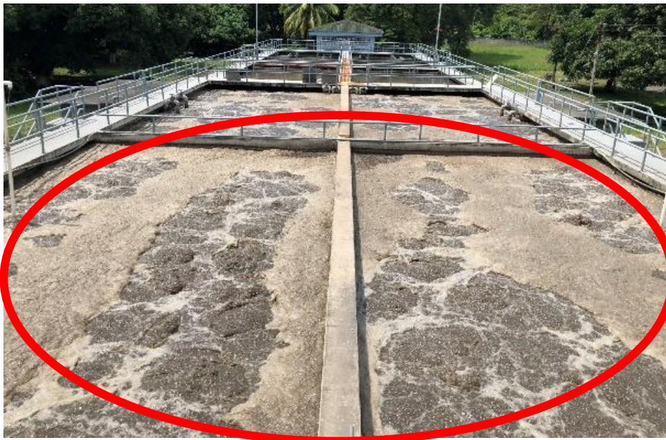
Fotografía 9. Reactor secundario seccionado a la mitad de su volumen aproximadamente.
