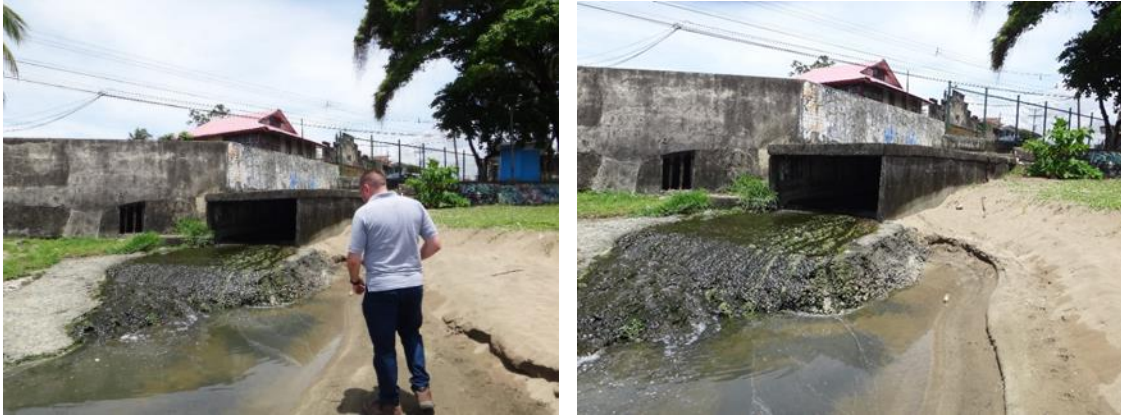
Fotografía 1y 2. Descarga de aguas pluviales al sector de la playa Los Baños en limón Centro.
